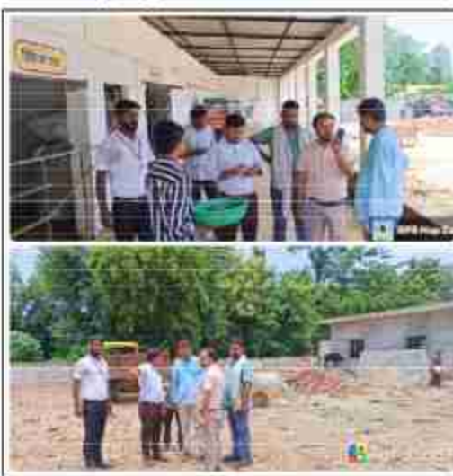
ने आकांक्षी नगर योजना में निर्माणाधीन गौशाला का मंगलवार को अधिशासी अधिकारी सचिन कुमार चौधरी ने निरीक्षण किया। निरीक्षण के दौरान अधिशासी अधिकारी सचिन कुमार चौधरी ने ठेकेदार को निर्देशित किया गया कि कार्यों की गुणवत्तापूर्ण समय से पूर्ण किया जाये। उन्होंने भवन निर्माण की गुणवत्ता पर विशेष ध्यान देने और काम जल्द पूरा करने को कहा। निरीक्षण के दौरान मुख्यमंत्री शाही फेलो विनय कुमार घटेल और लिपिक राजेश कुमार त्रिपाठी मौजूद रहे।
